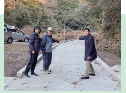
大雨で毎年冠水していた市道大宮線に新しい側溝を取り付けました。
